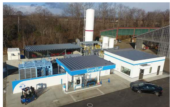
図11 水素製造施設、水素ステーション
